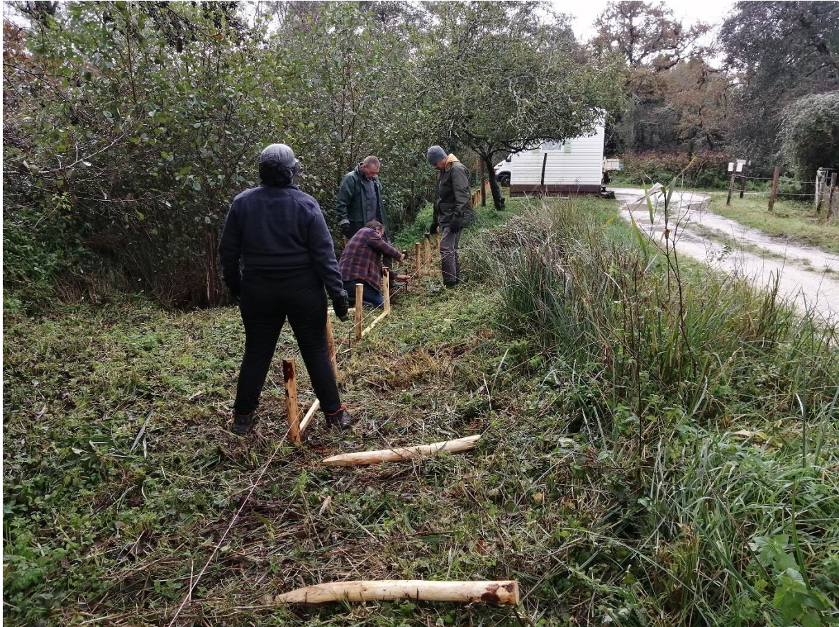
Chantier de pose de la barrière de protection à amphibiens - entreprise ARESCOP
